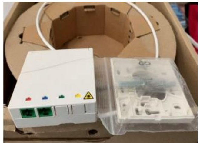
OTO und Gebäudeverkabelung
